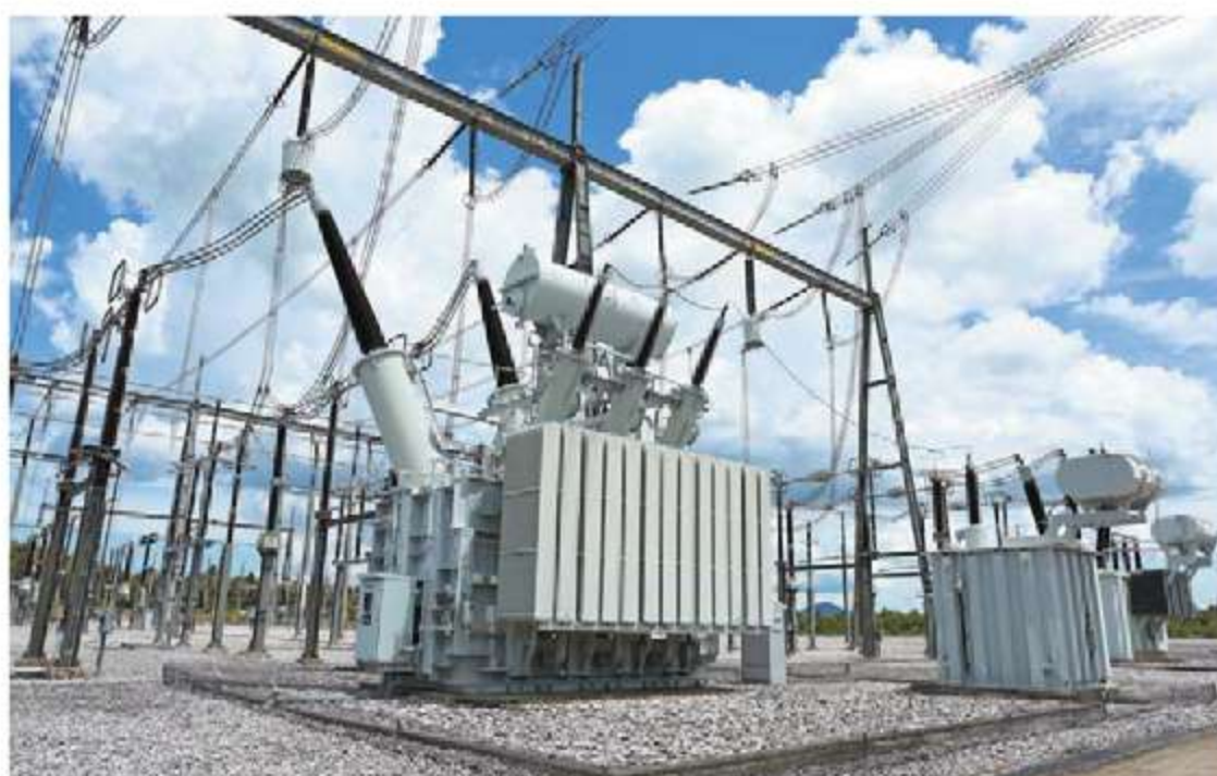
Rys. 26.2 Transformator energetyczny wysokiego napięcia na stacji energetycznej
